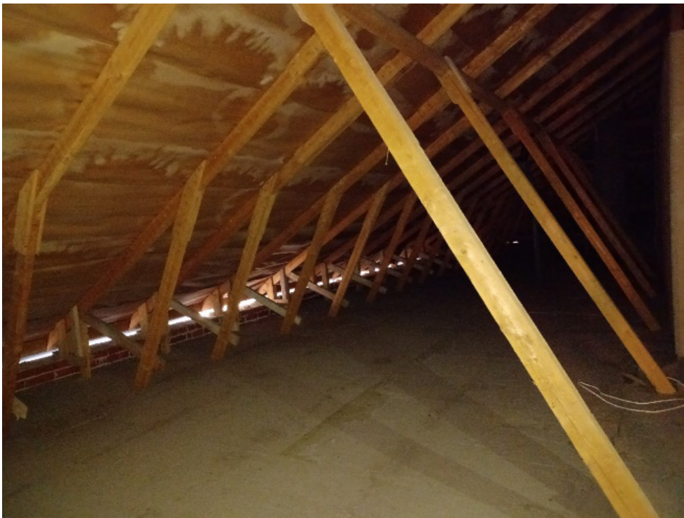
Kuva 99 Ullakon kattotuolit. Yläpohja on lämpöeristetty, mutta lattialaudoitusta ei ole.
