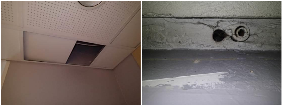
Kuvat 74 ja 75. Tilan 116 alakaton takana havaittiin tulppaamattomia putkia, joiden kautta todettiin ilman liikkuvan.
