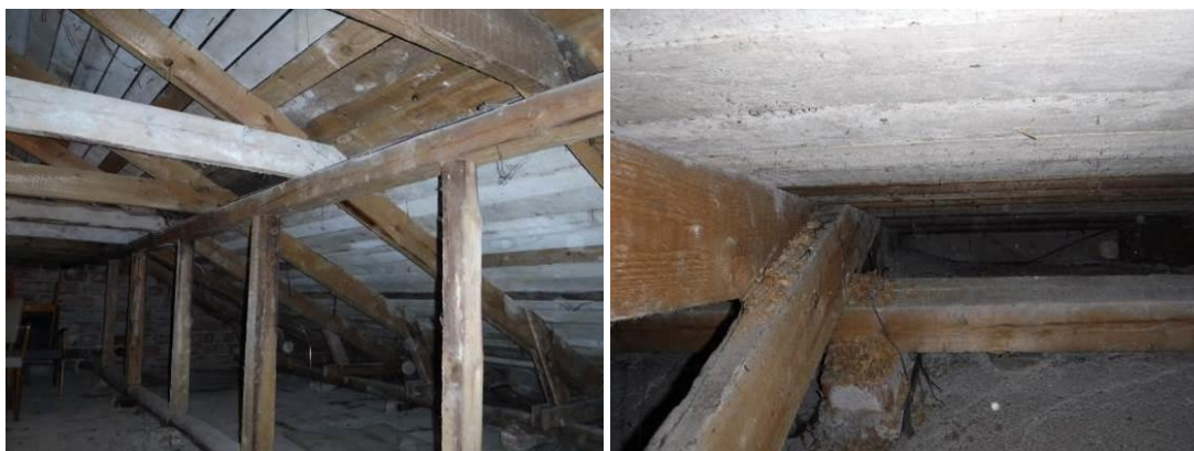
Kuvat 60 ja 61. Lounas-koillisen suuntainen ullakkotila, jonka räystään tuuletus havaittiin puutteelliseksi.
