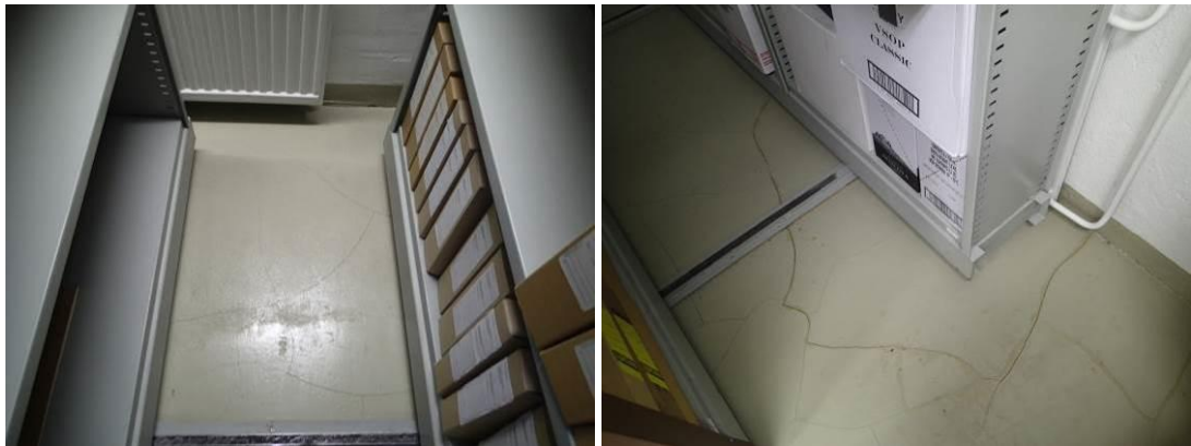
Kuvat 7 ja 8. Vanhemman arkiston lattian halkeamista osa on injektoitu ja niiden kautta ei havaittu ilmavuotoa.
