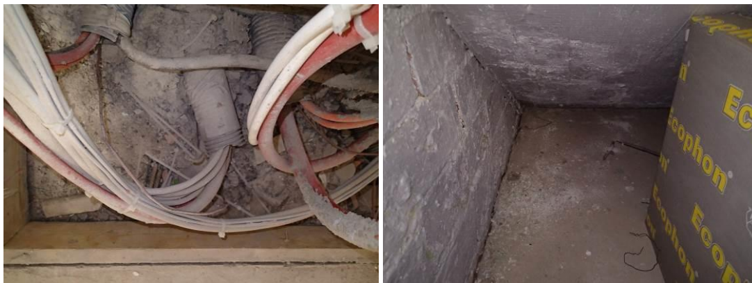
Kuvat 11 ja 12. IV-laitetilan kaapelisuoja-putkien kautta havaittiin ilman virtaavan. Portaikon alla havaittiin kosteusjälkiä.
