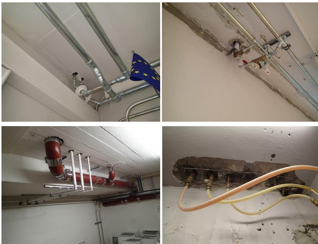
Kuvat 68 - 71. Avoimien välipohjan putkiläpivientien kautta todettiin ilman liikkuvan välipohjarakenteen ja sisätilojen välillä.
