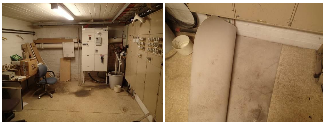
Kuvat 9 ja 10. Sähköpääkeskuksen muovimattoja ei ole liimattu kiinni alustaan.
