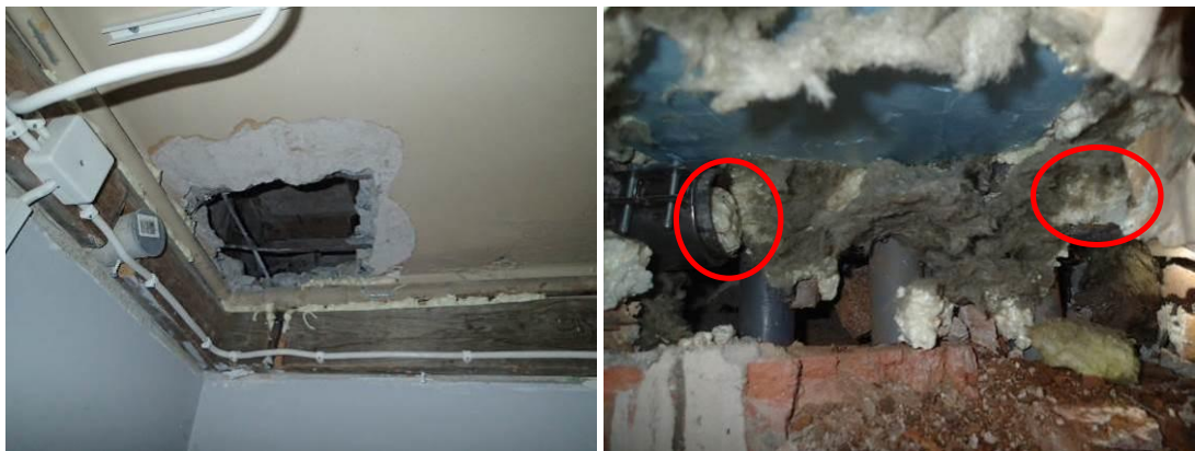
Kuvat 112 ja 113. Välipohjaontelon sisällä havaittiin mineraalivillalla ja uretaanivaahdolla tukitut viemärinpäät.
