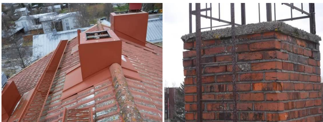
Kuvat 50 ja 51. Vanhojen painovoimaisten hormien yläpäävät ovat sadevesille avoinna. Vanhan savupiipun muuraus on huonossa kunnossa.
