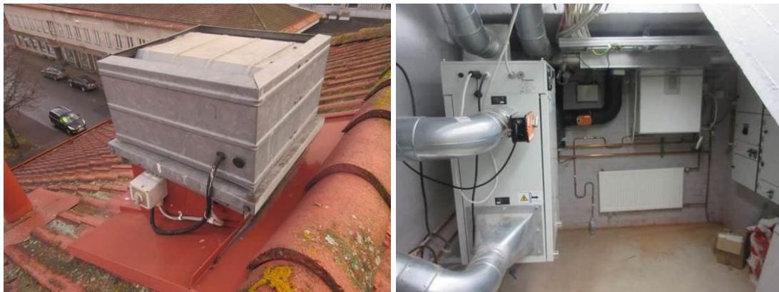
Kuva 133 ja 134. Huippuimuri rakennuksen vesikatolla sekä kellarin laitetilassa oleva ilman kuivain.
