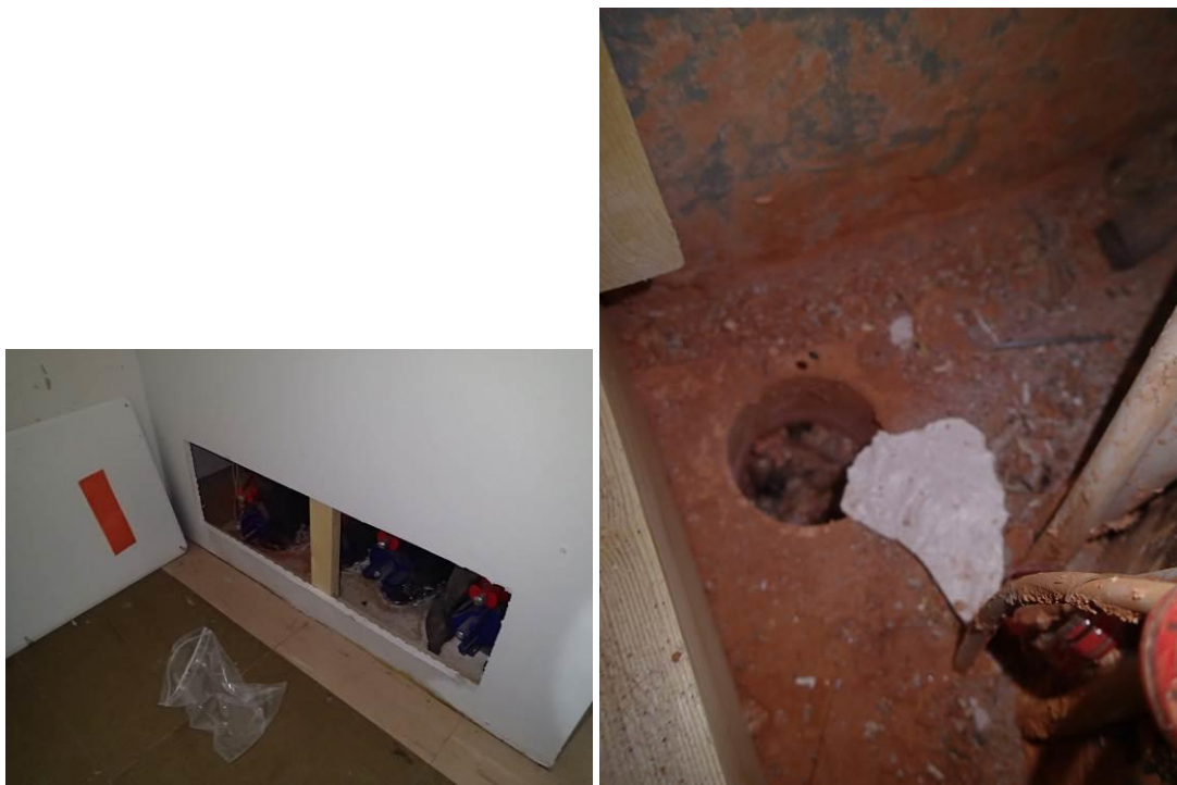
Kuvat 125 ja 126. Pohjoiskulman portaikossa olevan koteloinnin sisällä olevat läpiviennit ovat paikoin tiivistämättä.
