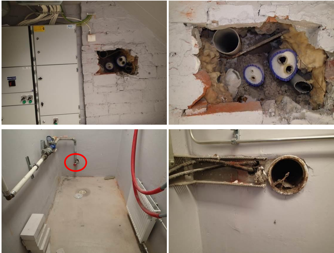
Kuvat 37 - 40. Läpivientejä sekä käytöstä poistettuja putkiasennuksia, joiden kautta havaittiin ilmavuotoja sisätilojen suuntaan. Yläkuvissa IV-laitetila ja alempana vesimittaritila.
