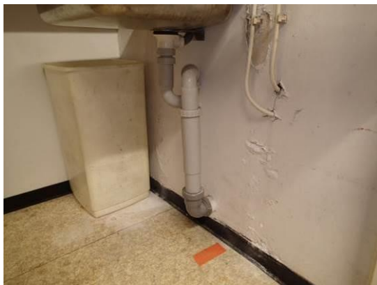
Kuva 109. Kolmannen kerroksen siivoustilassa 313 seinätasoitteet kupruavat samalla kohdalla kuin välipohjassa todettiin viiltomittauksessa poikkeavaa kosteutta.
