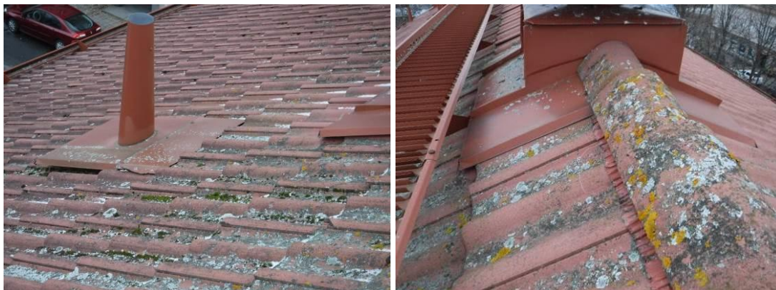
Kuvat 48 ja 49. Vesikatteen pinnassa havaittiin paikoin sammalta.
