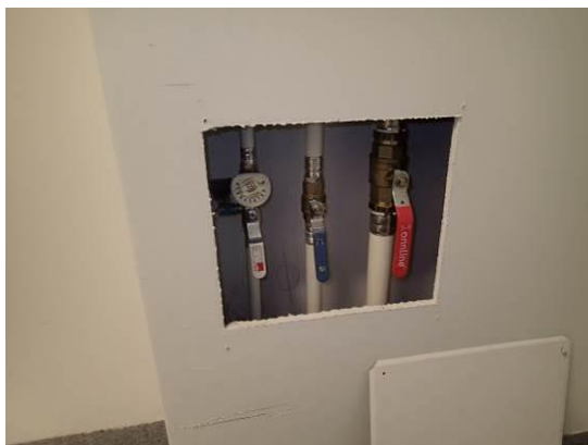
Kuva 118. Ensimmäisen kerroksen kipsilevykotelo on poikkeavan lämmin. Lämminvesikierron säätö havaittiin olevan tekemättä.
