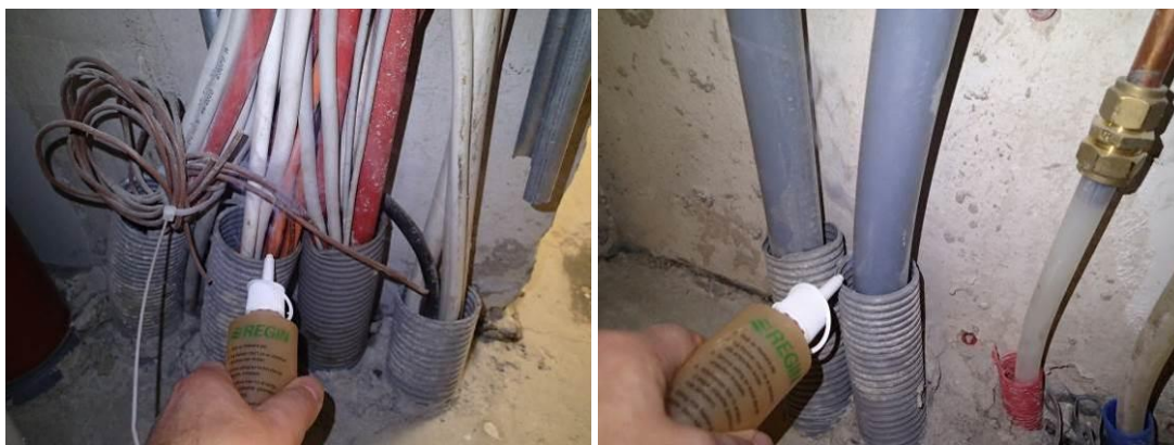
Kuvat 3 ja 4. Päätearkiston 17 edustalla olevien suoja-putkien kautta havaittiin ilman virtaavaan sisäänpäin.
