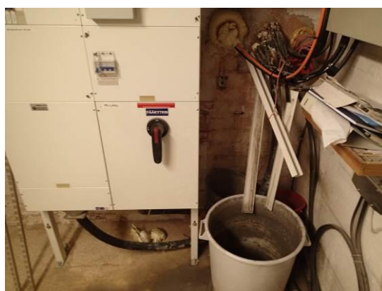
Kuva 36. Sähköpääkeskustilan maanvastaisen seinän vuotojälkiä.
