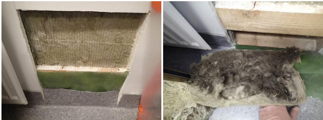
Kuvat 29 ja 30. Kokoustilan 117 ja toimishuoneen 123 rakenneavauksissa (R6 ja R7) todettiin mineraalivillaeristeessä ilmanvuodon aiheuttamia jälkiä. Avauksesta R6 otetun näytteen N3 viljelytulokset voivat viitata mikrobikasvustoon.
