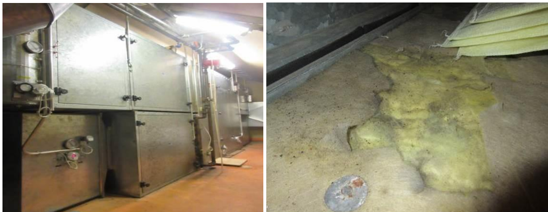
Kuvat 129 ja 130. Ilmanvaihtokone TK-1.1/PK-1.1 iv-konehuoneessa. Tuloilmakoneen suodatinosassa on lasikuitumatolla päällystettyä mineraalivillaa, joka oli paikoin rikkoutunut.
