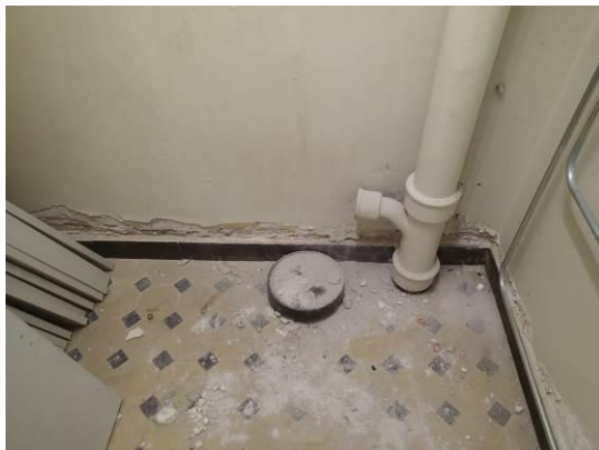
Kuva 108. Vanhan yleisö wc:n väliseinän alaosassa havaittiin rappauksen irtoamista.
