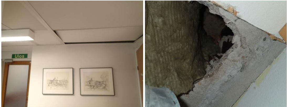
Kuvat 72 ja 73. Toisen kerroksen käytävän alakaton yläpuolella on tiivistämättömiä välipohjan läpivientejä.
