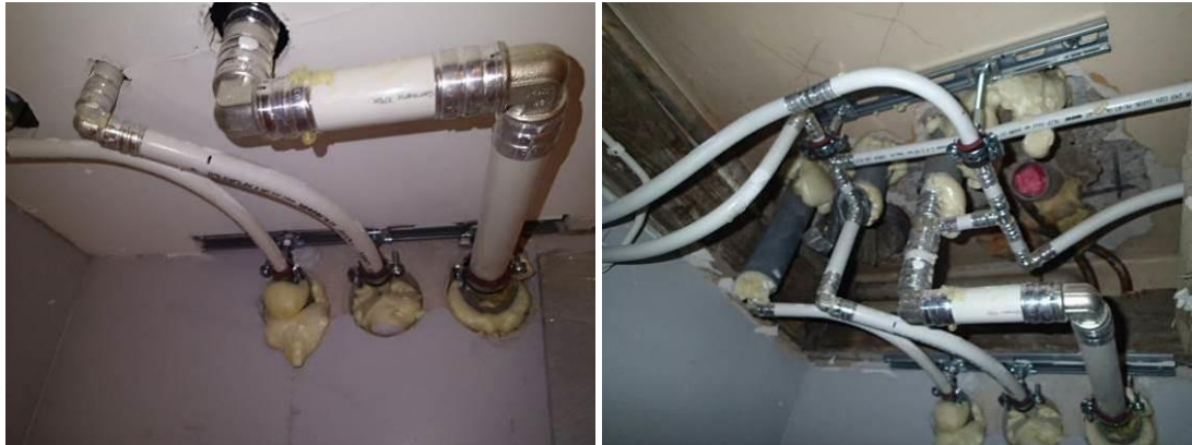
Kuvat 110 ja 111. Varaston 12 alakaton avauksen takana todettiin epätiiväviä läpivientejä välipohjassa.
