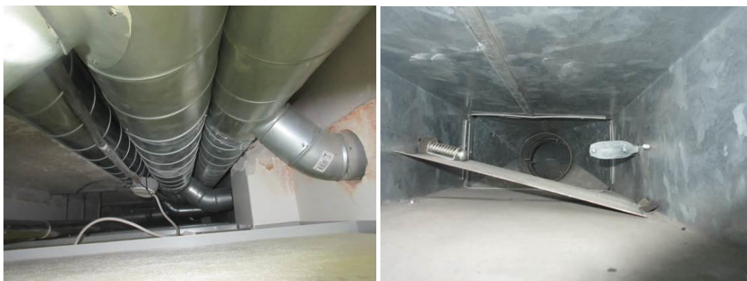
Kuva 135 ja 136. Uusittuja ilmanvaihtokanavia sekä alkuperäisen likainen tuloilmapäätelaite, jossa rikkiäinen säätöosa.
