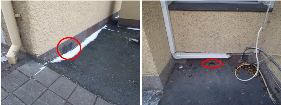
Kuvat 1 ja 2. Rakennuksen maanvastaisen seinän yläosassa on läpivientejä, joiden alareunat ovat osin maanpinnan tason alapuolella.
