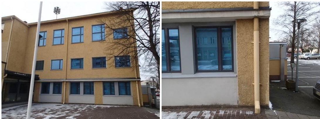
Kuvat 17 ja 18. Ensimmäisen kerroksen ikkunoiden päällä on betonirakenteinen lippa. Kattovesien syöksytorvien kohdilla rappauspinta irtoilee lipasta.
