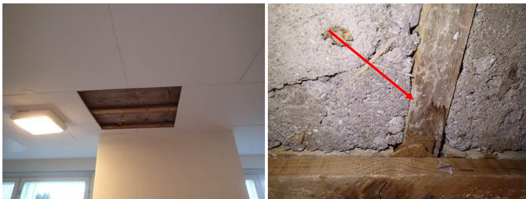
Kuvat 66 ja 67. Avaus R19 tehtiin aulan 321 yläpohjaan. Kohdassa havaittiin mikrobiperäistä hajua. Kuvassa näkyy myös betonirakenteeseen upotettu puurima, jossa todettiin kosteuden aiheuttamia jälkiä.
