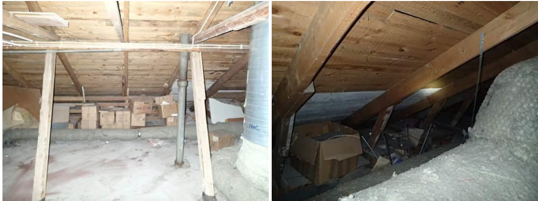
Kuvat 52 ja 53. Aluslaudoituksen havaittiin olevan pääosin hyväkuntoista. Oikeanpuolisessa kuvassa näkyy uusitun ja vanhan laudoituksen raja.
