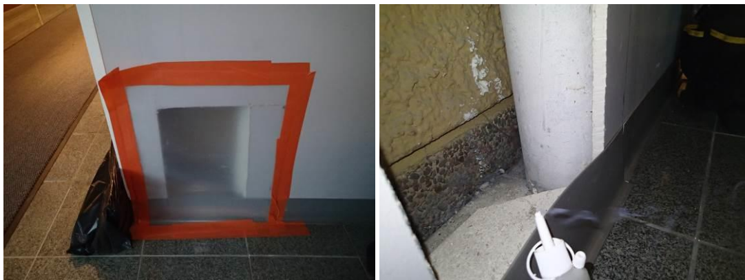
Kuvat 123 ja 124. Ensimmäisen kerroksen hissiaulan koteloinnin sisältä virtasi tunkkaista ilmaa sisätilojen suuntaan.
