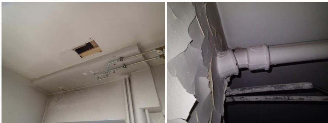
Kuvat 76 ja 77. Tilan 112 alakaton luukun kautta havaittiin alakaton yläpuolisessa tilassa ulkoseinän maalipinnan lohkeilua sekä avoimia talotekniikan putkia.
