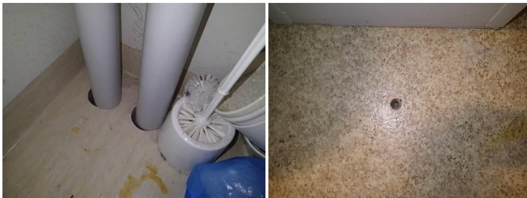
Kuvat 85 ja 86. Vasemman puoleisessa kuvassa on siivouskomeron 115 läpiviennit, joita ei ole tiivistetty. Oikeanpuoleisessa kuvassa on wc:n 109 lattiassa oleva reikä.
