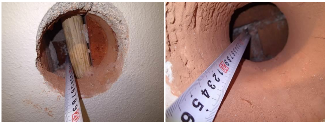
Kuvat 32 ja 33. Toisen kerroksen ulkoseiniin tehdyissä porauksissa ei havaittu eristettä ulkoseinärakenteessa.
