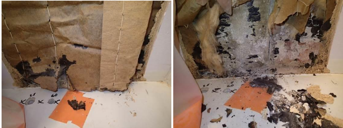
Kuvat 106 ja 107. Pukuhuoneen 6 väliseinäavauksesta otetussa mineraalivillaeristeenäytteessä todettiin esiintyvän mikrobikasvustoa.
