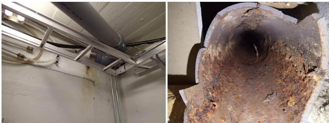
Kuvat 116 ja 117. Varaston 126 seinän yläosassa on vanha tulppaamaton viemäriputken pää avoinna.
