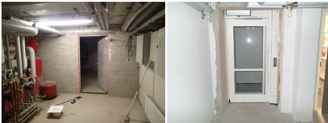
Kuvat 102 ja 103. Lämmönjakohuoneen ja sen edustalla olevan käytävän seinät ovat tasoitepinta-aset. Hissikuilun liittymien kautta tapahtuu ilmavuotoa ylempiin kerroksiin.
