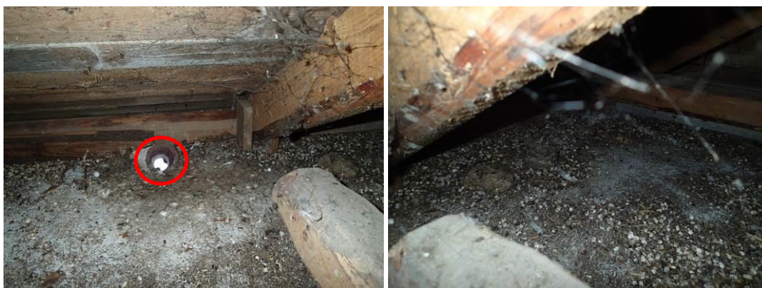
Kuvat 58 ja 59. Ullakkotilan tuuletusputkista puuttuu verkko ja näillä kohdin palopermannon päällä on runsaasti lintujen ulostetta.
