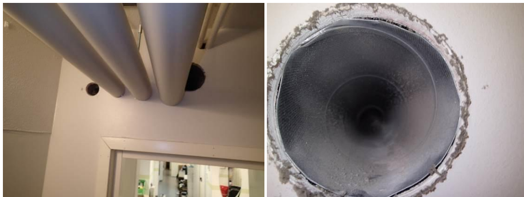
Kuva 137 ja 138. Esimerkiksi ATK-osaston wc:stä puuttuu poistoilmaventtiili.
