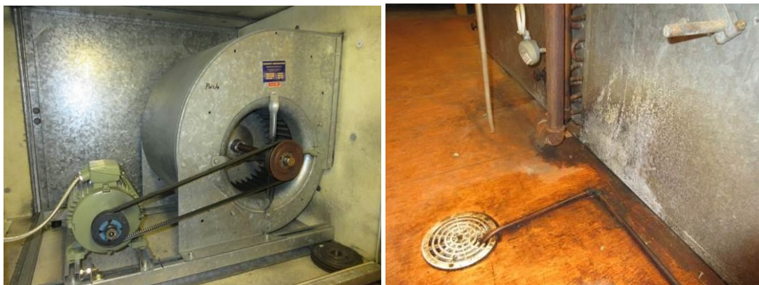
Kuvat 131 ja 132. Poistoilmapuhallin sekä lauhdevesiviemärointi kupariputkella lat-tiakaivoon.
