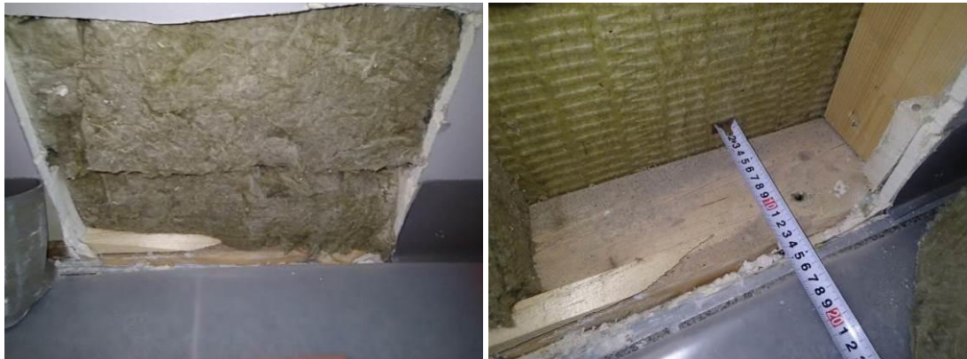
Kuvat 27 ja 28. Vuonna 2006 tehdyn pääsisäänkäynnin kohdalle tehdyissä avauksissa (R1 ja R2) ei havaittu aistinvaraisesti poikkeavaa, mutta näytteen N1 viljelytulokset voivat viitata mikrobikasvustoon.
