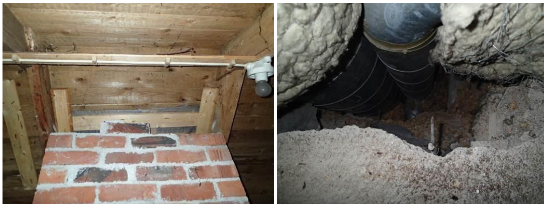
Kuvat 56 ja 57. Vanhojen painovoimaisten hormien yläpää on paikoin katkaistu vesikataton alapuolelta. Ilmanvaihtokanavien läpiviennit palopermannon läpi ovat epätiivittä.
