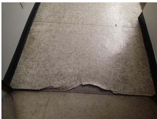
Kuva 87. Monistustilan 112 oven edustalla muovimatto on rikkoutunut.
