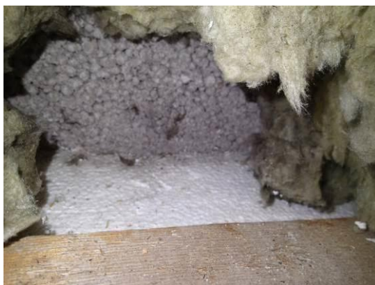
Kuva 31. Rakenneavausten kohdalla R6 ja R7 ulkoseinän puurungon ja harkon välissä on styrox-eriste. Tuulensuoja puuttuu rakenteesta.
