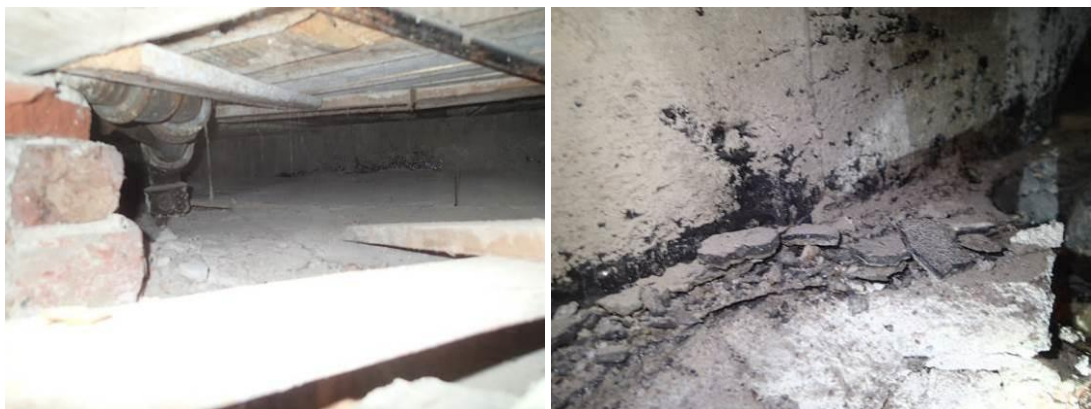
Kuvat 114 ja 115. Ontelotilassa oleva viemäri laskee alas väliseinän sisällä. Välipohjaontelon alapinnassa on paksu bitumikerros, joka haisee voimakkaasti kreosootilta.
