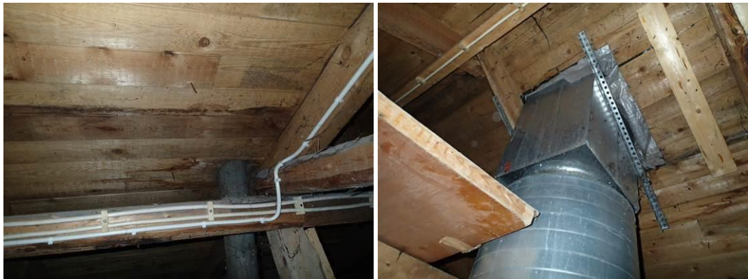
Kuvat 54 ja 55. Paikoin läpivientien kohdilla näkyi vesijälkiä ja aluskatteen liitoksissa havaittiin puutteita.
