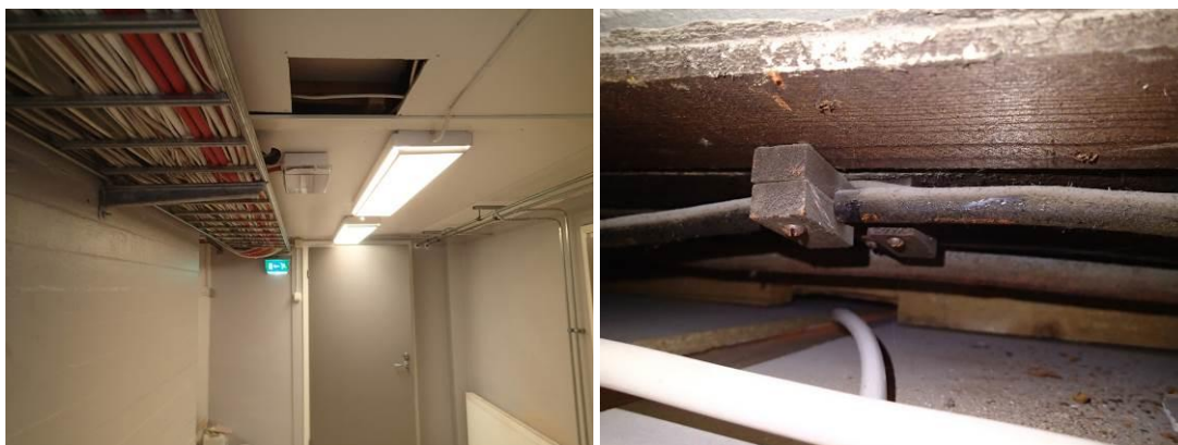
Kuvat 83 ja 84. Kellarikerroksen käytävän alakaton yläpuolella on mm vanhoja sähköasennuksia, jotka saattavat sisältää PAH-yhdisteitä.
