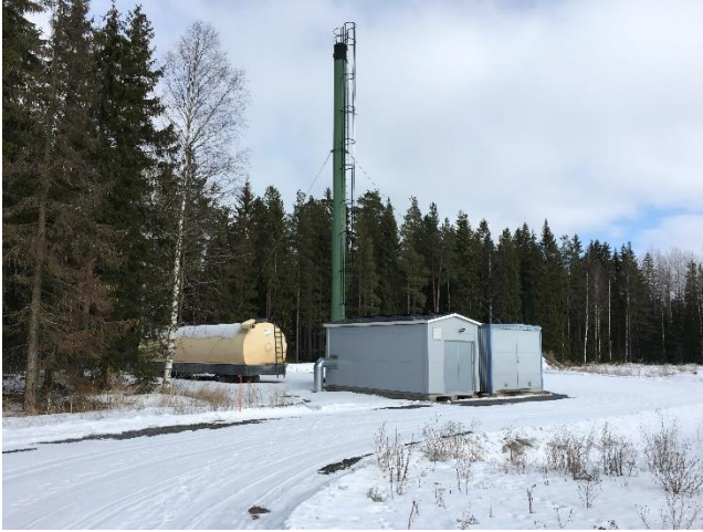
Loimaan kaukolämmön varavoimalaitos
